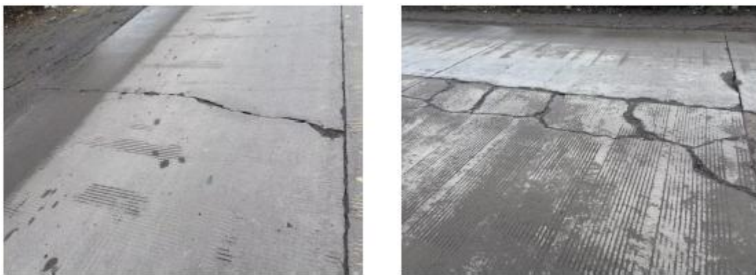
图 2-2 现状水泥路面典型病害
