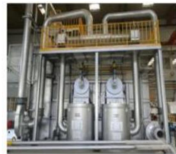
图6.1-5调研单位急冷蓄热系统照片
