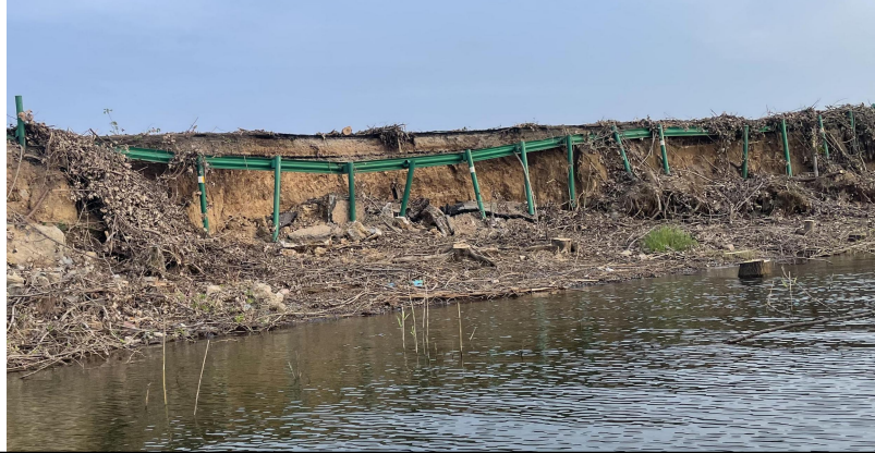
二里涧桥~反修桥段沿岗河堤岸坍塌严重
