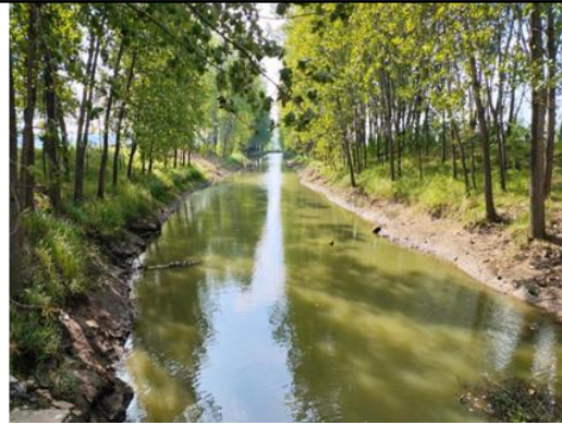
图 3-16 引水渠堤脚冲刷
