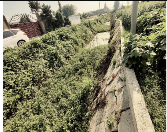
图 3-20 已护砌渠段杂草丛生 2
