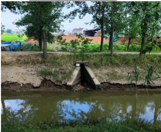
图 3-9 岸坡冲刷、左岸生产道
