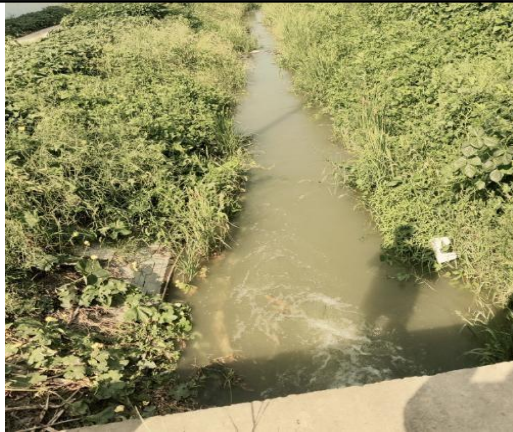
图 3-19 已护砌渠段杂草丛生 1
