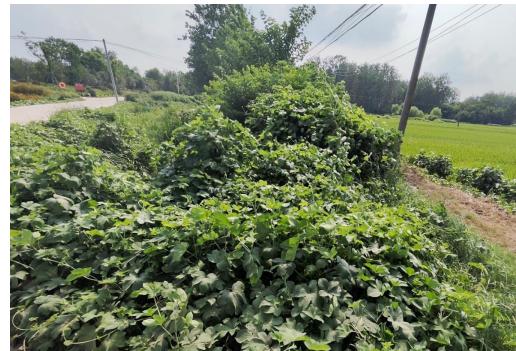
图 3-18 现状渠道被掩埋
