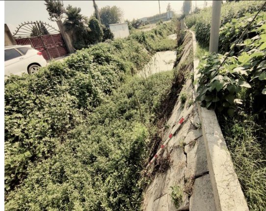
图 3-14 已护砌渠段杂草丛生 2
