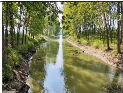
图 3-10 引水渠堤脚冲刷
