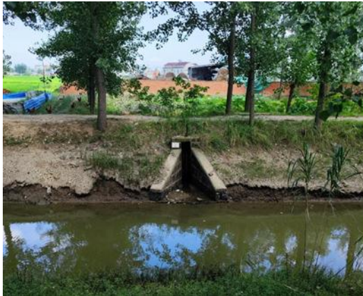
图 3-3 岸坡冲刷、左岸生产道
