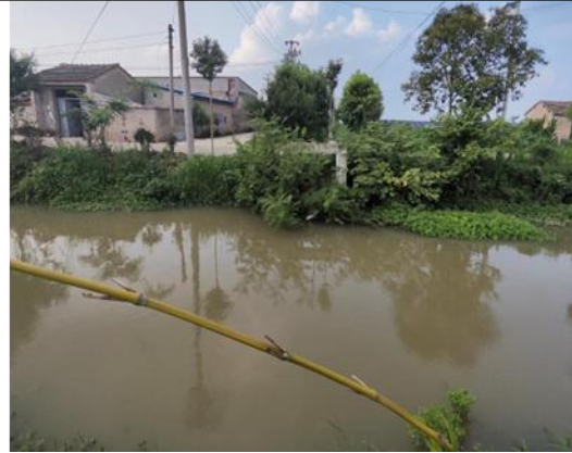
图3-6 岸坡杂草丛生
