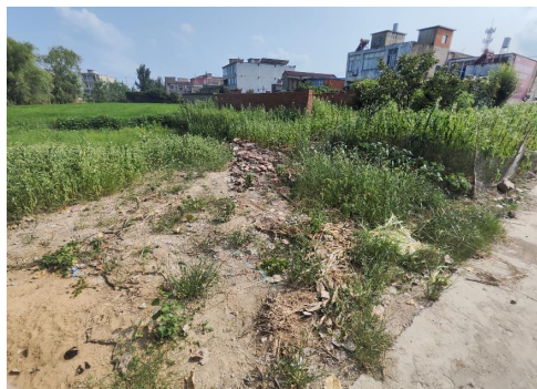
图 3-11 现状渠道杂草丛生、淤积严重
