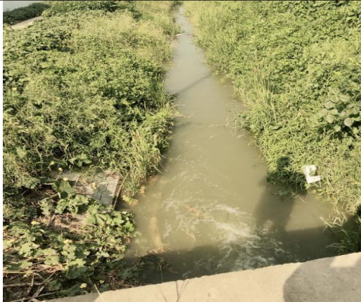
图 3-13 已护砌渠段杂草丛生 1
