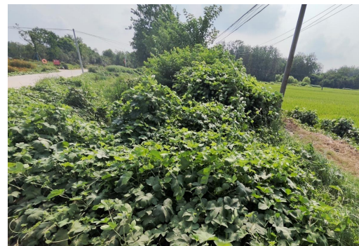
图 3-12 现状渠道被掩埋
