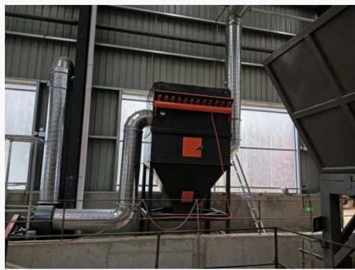
制砖产线布袋除尘器
