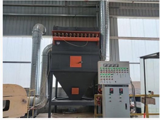
破碎产线布袋除尘器
