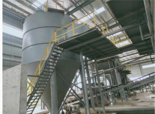
三氢净化一体罐
