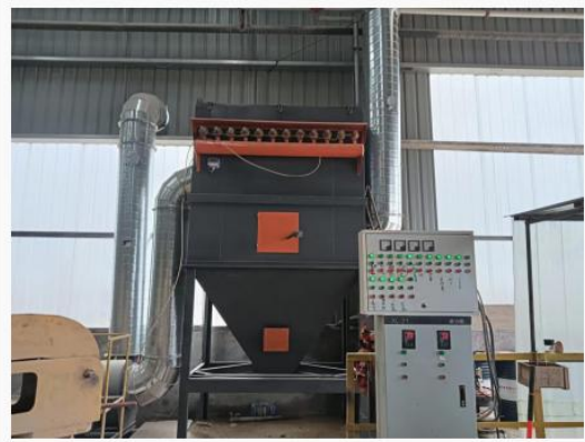
破碎产线布袋除尘器
