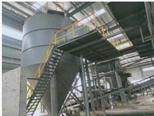
三氢净化一体罐
